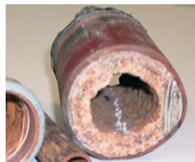
Twarda woda to zagrożenie dla kotłowni – powoduje m.in. znaczne obniżenie sprawności cieplnej urządzeń
