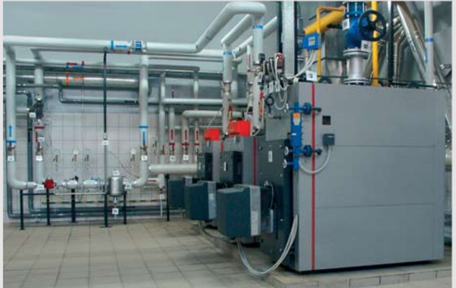
Rys. 15: Kotlewnia z trzema kotłami Vitoplex – jednym niskoprężnym kotłem parowym i dwoma kotłami wodnymi
