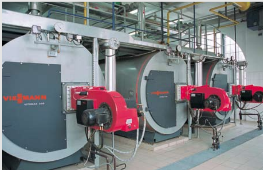
Rys. 71: Zaopatrzenie w parę szpitala AMH w Chorzowie, Polska – trzy wysokopięne kotły parowe Vitomax 200 HS o wydajności 2,4 t/h (8 bar) zasilają parą ogrzewanie, pralnię i sterylizatornię
