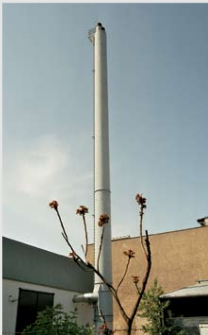
Rys. 24: Instalacja odprowadzania spalin (źródło: ASETEC)
