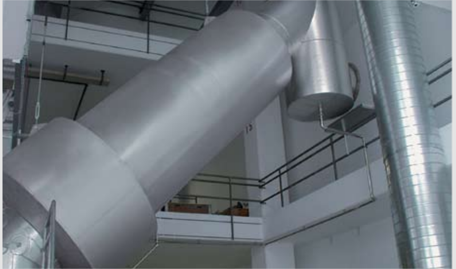
Rys. 74: Tłumik szumów przepływu spalin
