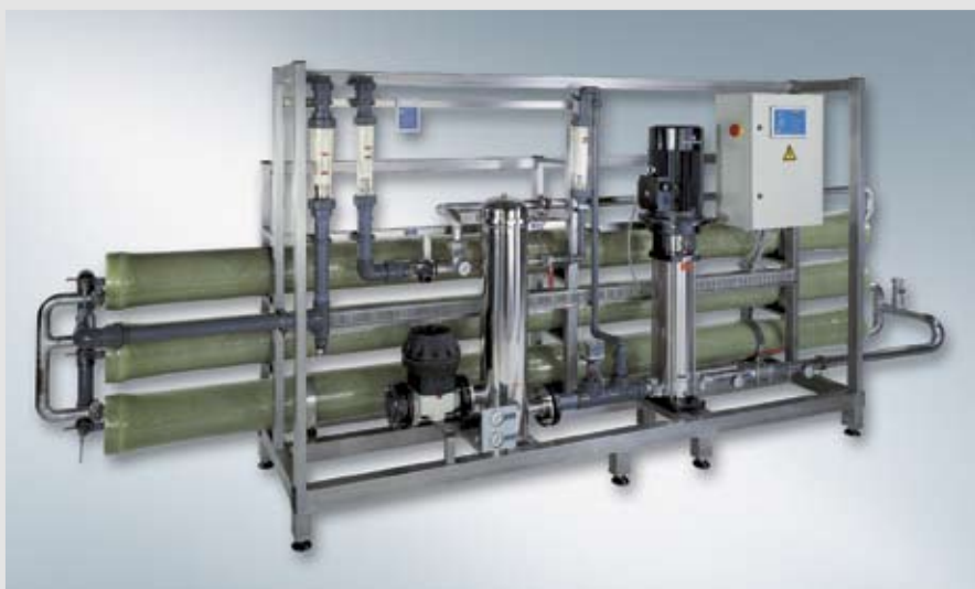
Rys. 50: Instalacja osmozy odwróconej
