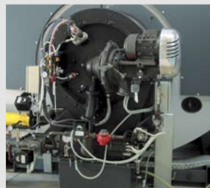
Rys. 38: Palnik dwupaliwowy na olej i gaz na kotle Vitomax 200-HS
