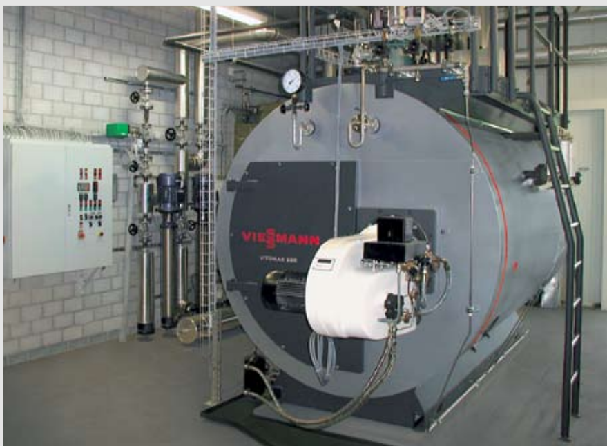
Rys. 29: Instalacja kotła parowego
