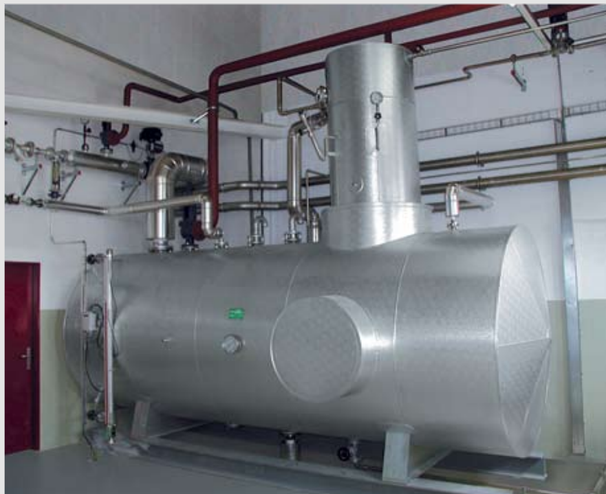
Rys. 56: Zbiornik wody zasilającej z odgazowywaczem termicznym
