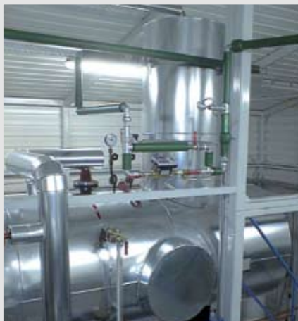
Rys. 52: Odgazowywacz niskociśnieniowy na zbiorniku wody zasilającej
