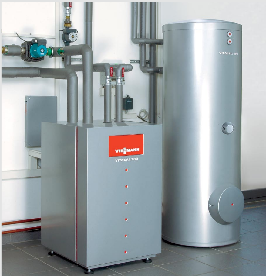
Rys. 66: Pompa ciepła solanka/woda i pojemnościowy podgrzewacz c.w.u.
