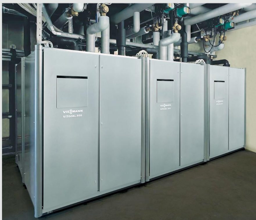
Rys. 59: Lokalna osiedlowa instalacja ciepłownicza w Szwecji – sześć pomp ciepła woda/woda Vitocal 300 dostarcza łącznie moc grzewczą 640 kW
