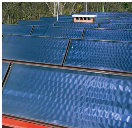
Kolektory słoneczne Vitosol 300-F można także ustawić poziomo.
