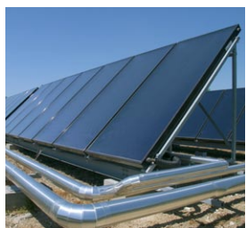
Kolektory Vitosol 300-F ustawione na powierzchni terenu.
