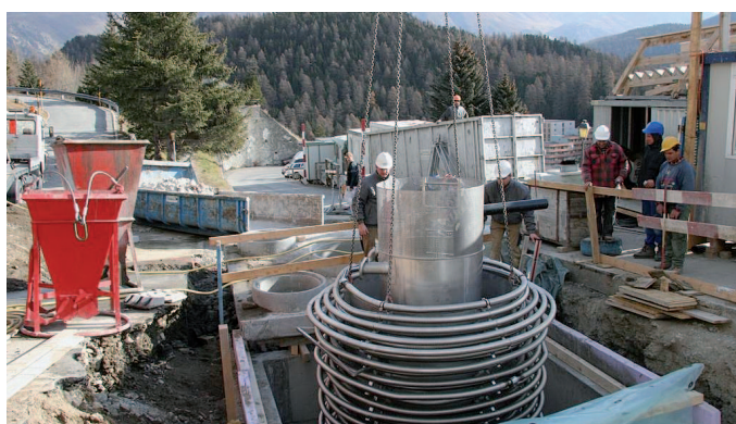
Ten wymiennik ciepła umieszczony w zbiorniku przepompowni ścieków służy jako źródło dolne pompy ciepła podgrzewającej c.w.u.
