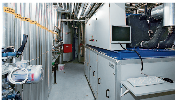
Pompa ciepła KWT o mocy 150 kW do podgrzewu c.w.u., pozyskująca ciepło ze ścieków.
